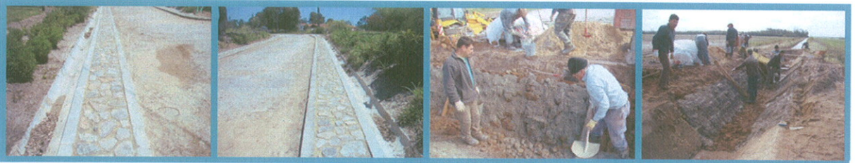
Figura 12: Reparação dos passeios no bairro da Bugalheira, reparação de Espaldas no Distribuidor das Craveiras
