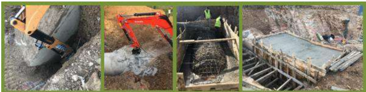
Figura 1: Rotura no sifão da Baiona
