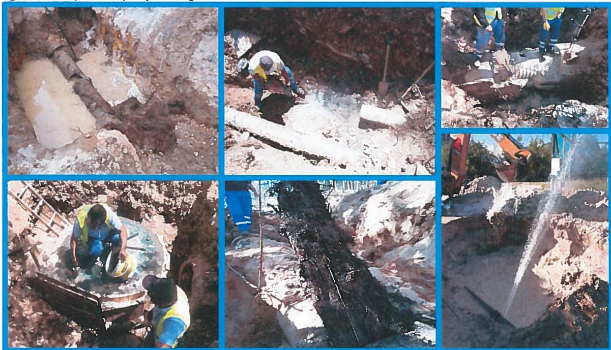
Figura 1: Exemplos da reparação de algumas roturas
