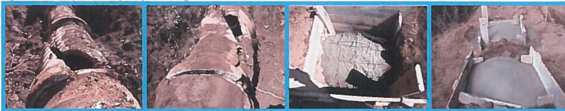
Figura 1: Exemplos da reparação de algumas roturas
