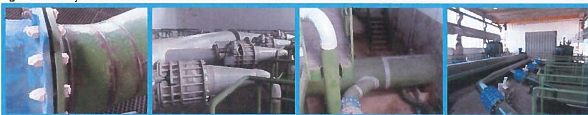
Figura 12: Estação Elevatória do Bloco XI
