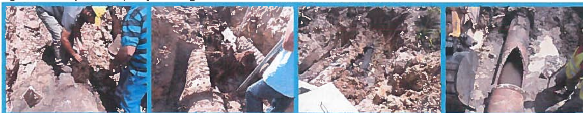
Figura 2: Exemplos da reparação de algumas roturas
