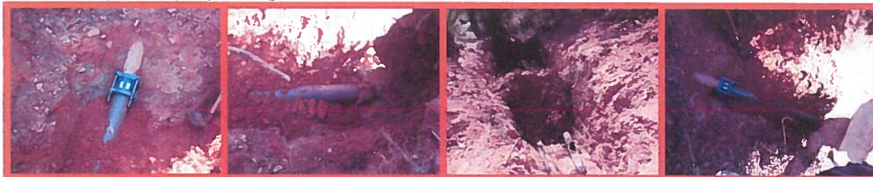
Figura 1: Exemplos da reparação de algumas roturas
