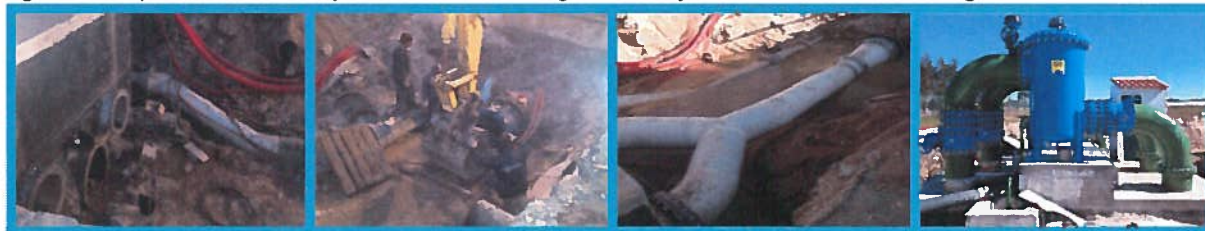
Figura 11: Empreitada de construção do sistema de filtragem na Estação Elevatória do Bloco de Rega XI
